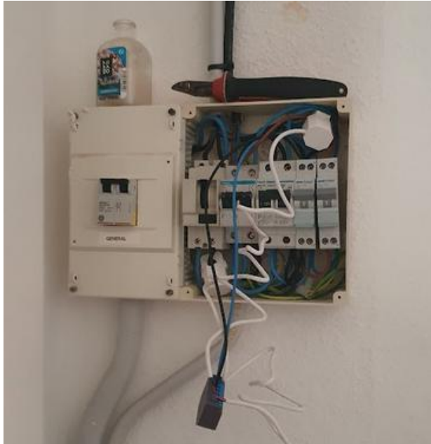
Proceso de instalación de 2 pinzas amperimétricas (DR)
